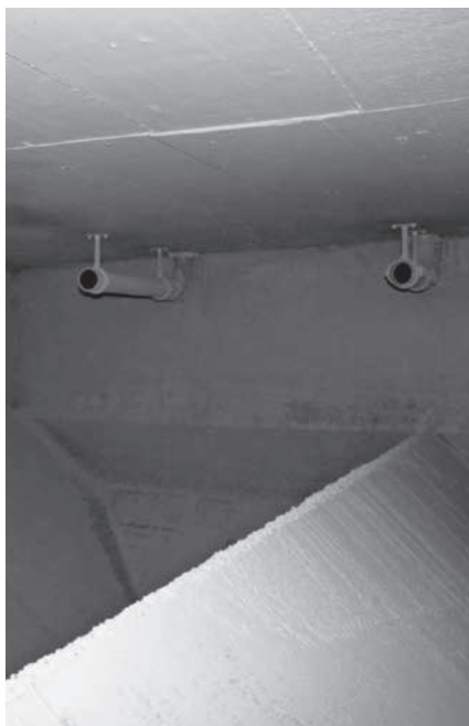
Hier lagern die Holzpellets, bevor sie in den Gebäuden der reformierten Kirche in Baar verheizt werden.
