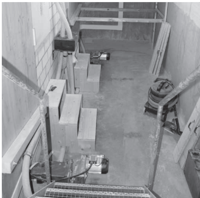
Über einen Einstiegsschacht und eine schmale Treppe gelangt man ins Lager für die Holzpellets.
