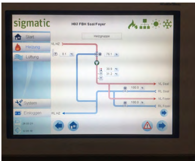
Ansicht der Heizungssteuerung im KiZ Ägeri
